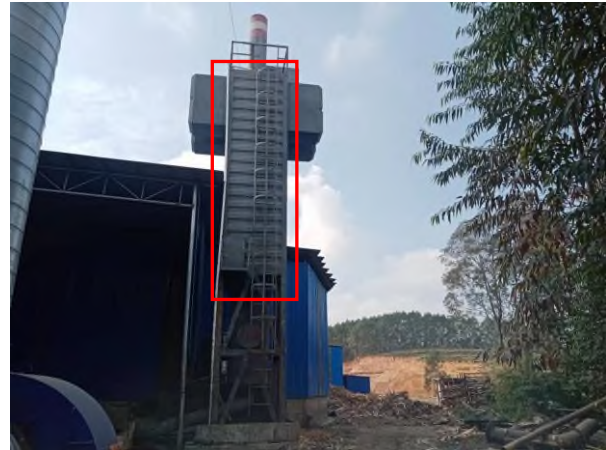
湿式静电除尘器
