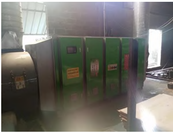
活性炭光氧一体机（1#排气筒）
