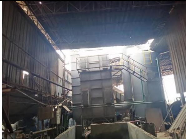
静电除尘器（3#排气筒）
