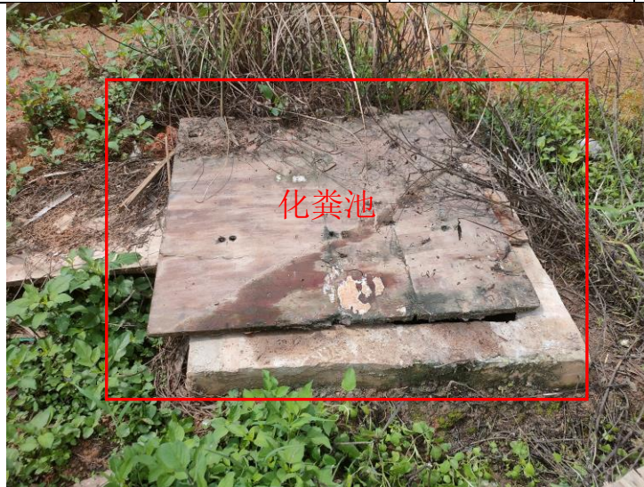
图 3-1 废水治理设施图
